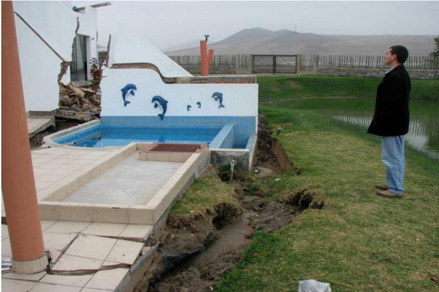
LICUACIÓN DE SUELOS, PLAYA LAS LAGUNAS – PANAMERICANA SUR KM 70.5
