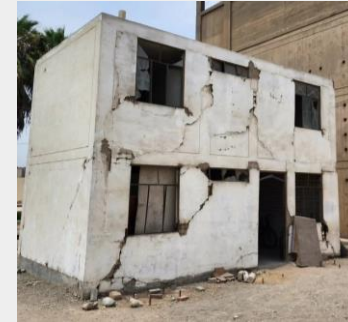
Daño típico en vivienda de albañilería confinada de ladrillo artesanal tras simulación sísmica (CISMID)
