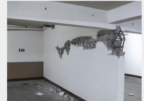
Falla por flexión y fuerza cortante.
