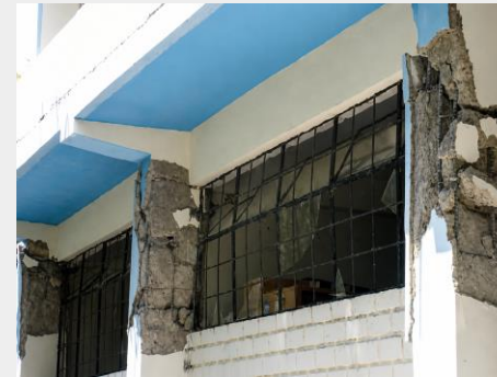
Falla por cortante y efecto de columna corta.
