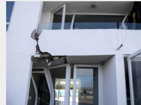
Falla por cortante y aplastamiento.
