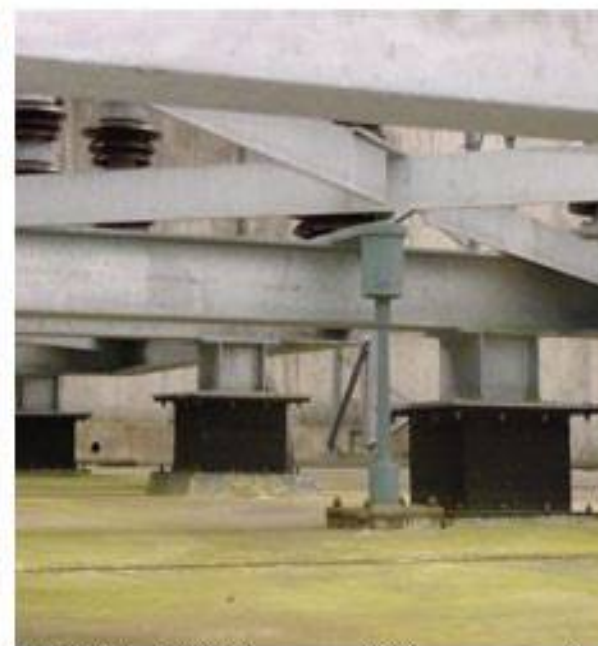
F-3AA9. Edificio en Chile apoyado sobre aisladores sísmicos.
