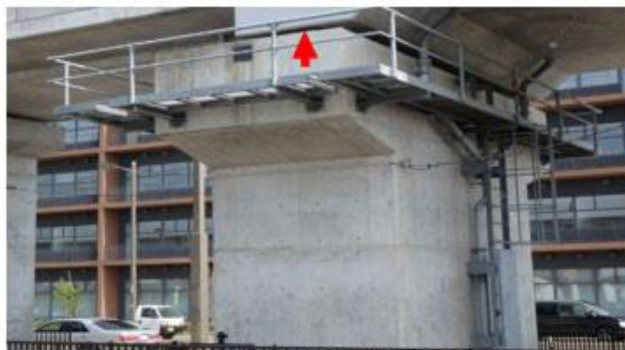
F-3AA6. Aisladores sísmicos entre la cara inferior de la viga del puente y la parte superior de la columna (Flecha roja).
