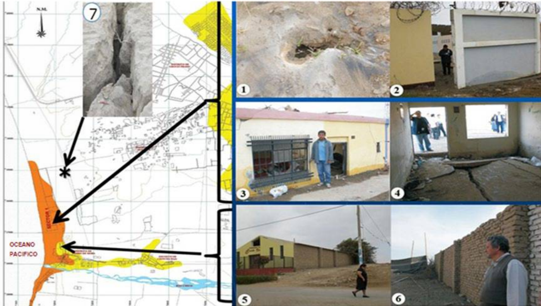
1) Licuación de suelos, clásico "volcán". 2) Desplazamiento lateral de una pared ( lateral spread ). 3) Hundimiento de una vivienda. 4) Al hundirse los muros, el piso se levantó y rajó. 5) Iglesia evangélica sin daños. 6) Muro de adobe construido a unos 12 m al sur de la iglesia sin daños. Escala: funcionario de Hábitat que mide aproximadamente 1.85m 7) Licuación generalizada y grandes grietas en la parte norte de Tambo de Mora.
