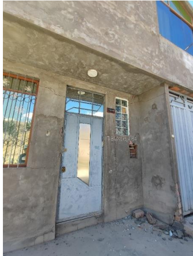
Figura 52 Agrietamiento en muros de albañilería de vivienda de tres niveles.
