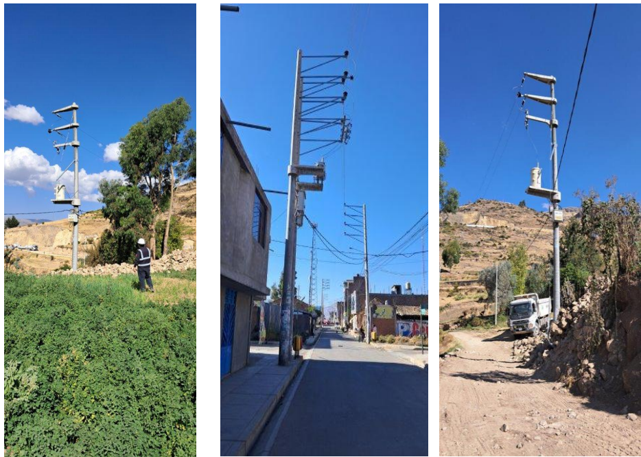
Figura 43 Subestación Aérea Monoposte. (a) Vista general de subestación aérea tipo monoposte en zona rural. (b) Subestación aérea y red de distribución eléctrica en zona urbana. (c) Vista general de subestación aérea tipo monoposte y elementos asociados.
