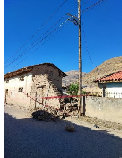
Figura 49 Colapso parcial del muro de fachada de una edificación de adobe.
