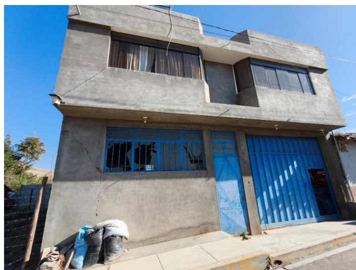
Figura 54 Agrietamiento en muro de albañilería no confinado de vivienda de dos pisos.
