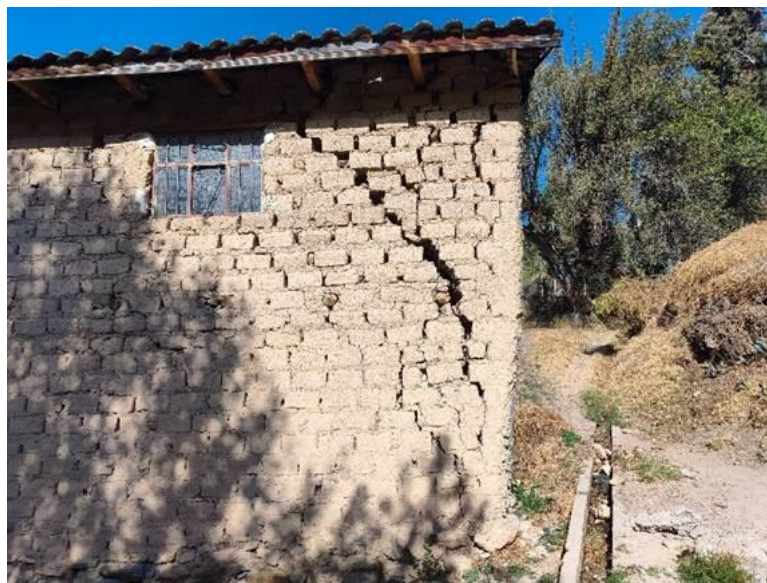
Figura 36 Daño en estructura de adobe de un piso.
