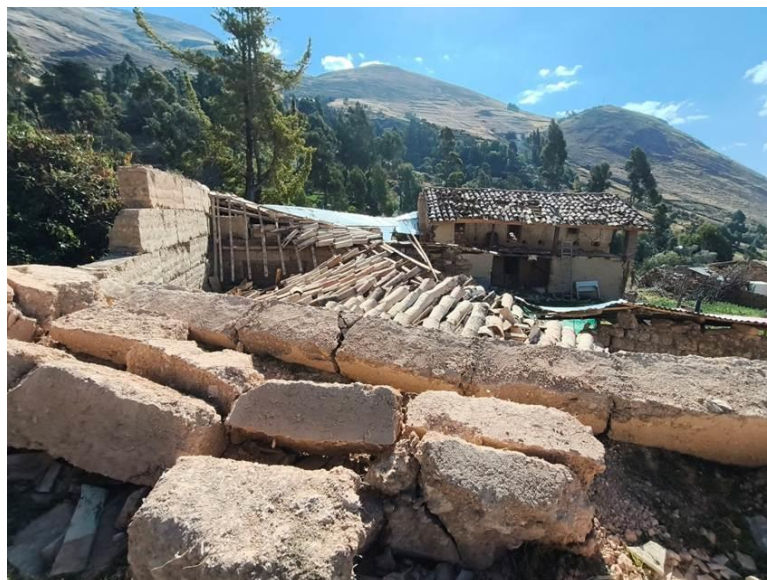
Figura 37 Colapso de una estructura de adobe.
