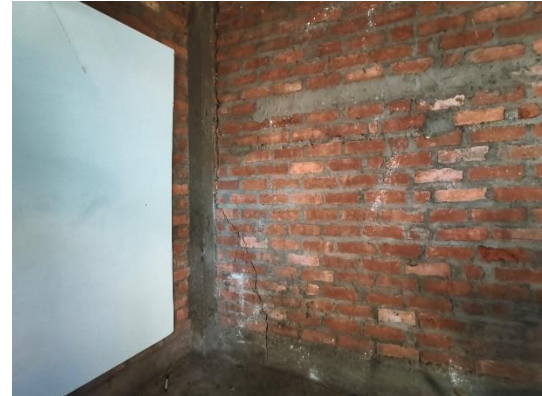
Figura 53 Grieta vertical en la unión entre muro de albañilería y columna de confinamiento.
