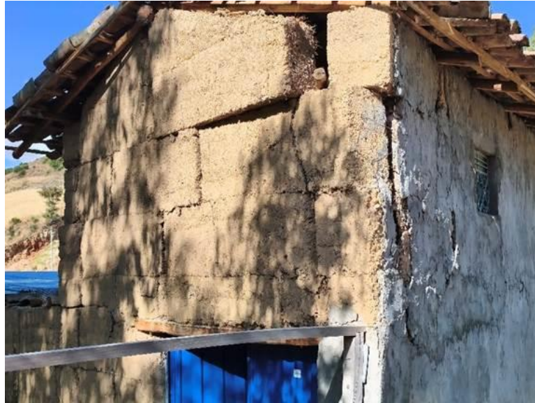
Figura 35 Daño en estructura de tapial de dos pisos con reforzamiento de malla de acero en una cara.
