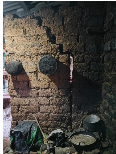
Figura 47 Agrietamiento y separación en el encuentro de muros de adobe.
