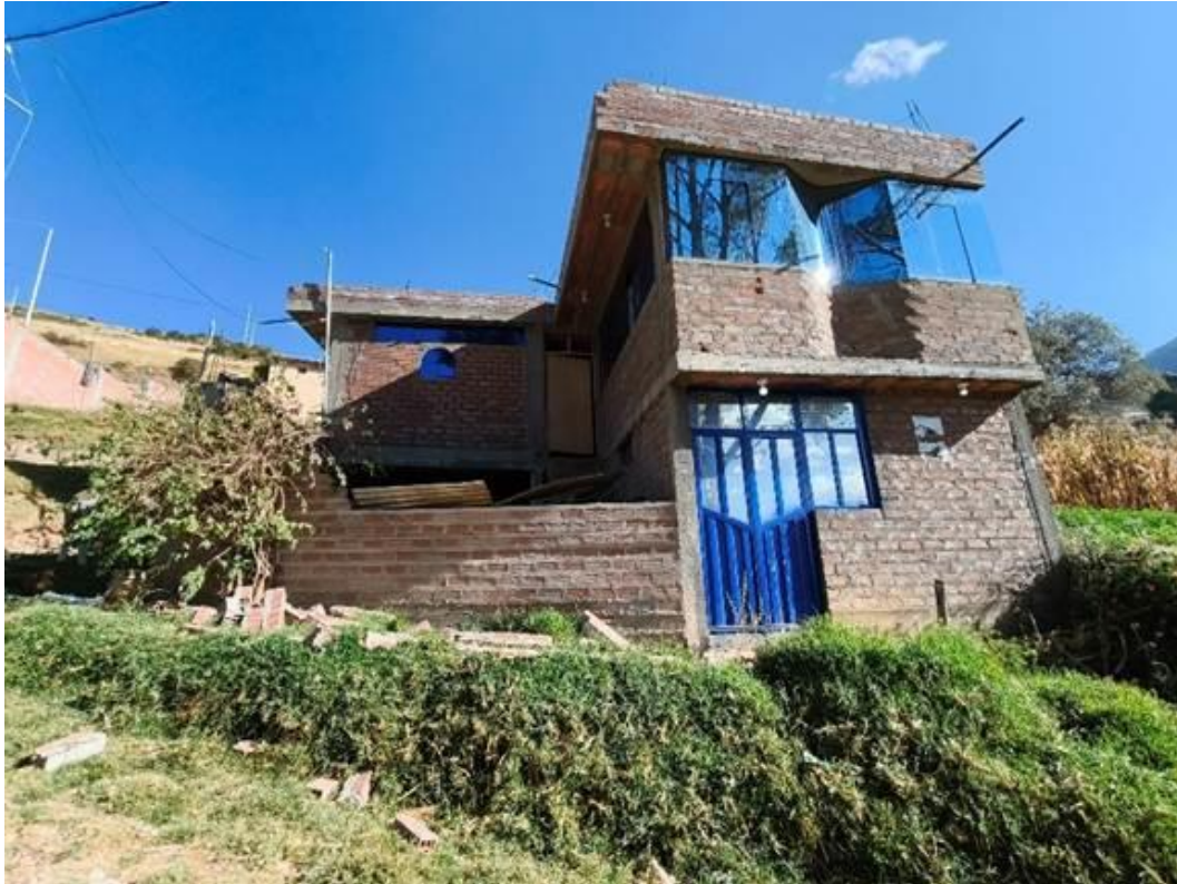
Figura 34 Estado de estructura de albañilería de dos pisos con ladrillos de arcilla cocida con confinamiento.
