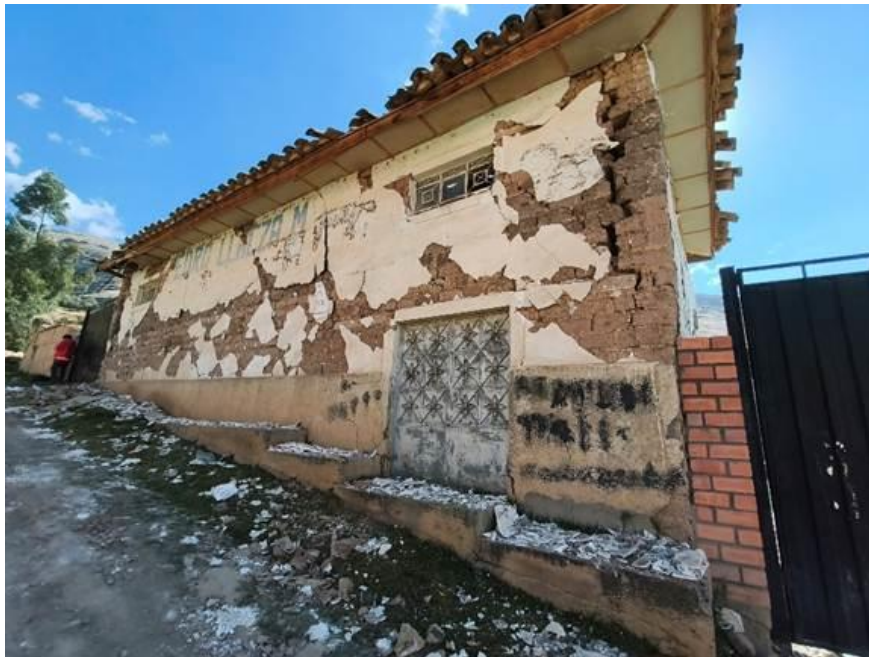
Figura 32 Daño en estructura de adobe de dos pisos.
