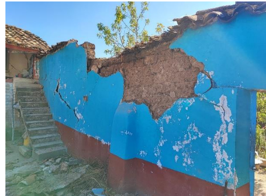
Figura 51 Daño severo y pérdida parcial de muro de adobe.
