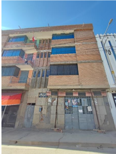
Figura 50 Daños en muros de albañilería de vivienda de cuatro niveles.
