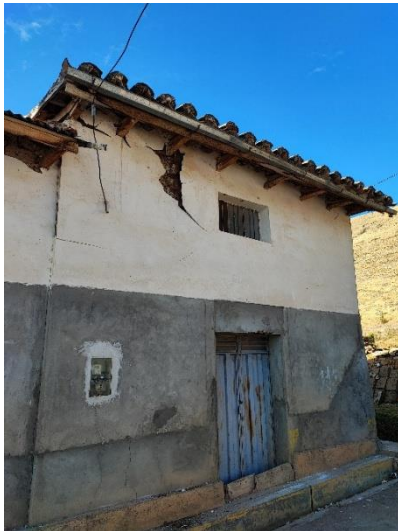
Figura 46 Daño sísmico en muro de adobe y zona de conexión muro–cubierta.
