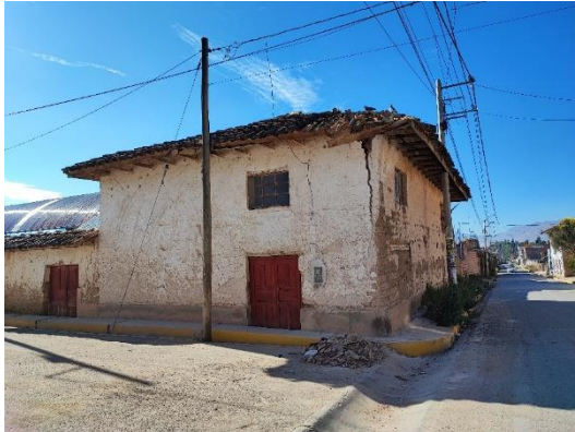
Figura 48 Agrietamiento en muros y daño en la cubierta de edificación de adobe de dos pisos.
