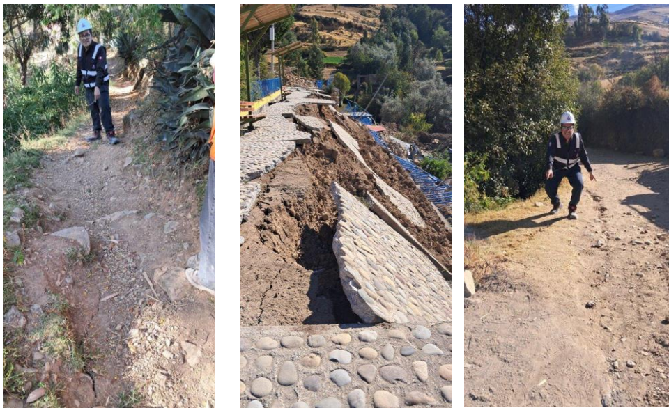
Figura 42 Caminos (a) Erosión y pérdida localizada de material en borde de camino. (b) Deslizamiento y pérdida parcial de soporte lateral en plataforma próxima a ladera. (c) Irregularidad y erosión superficial en camino local.
