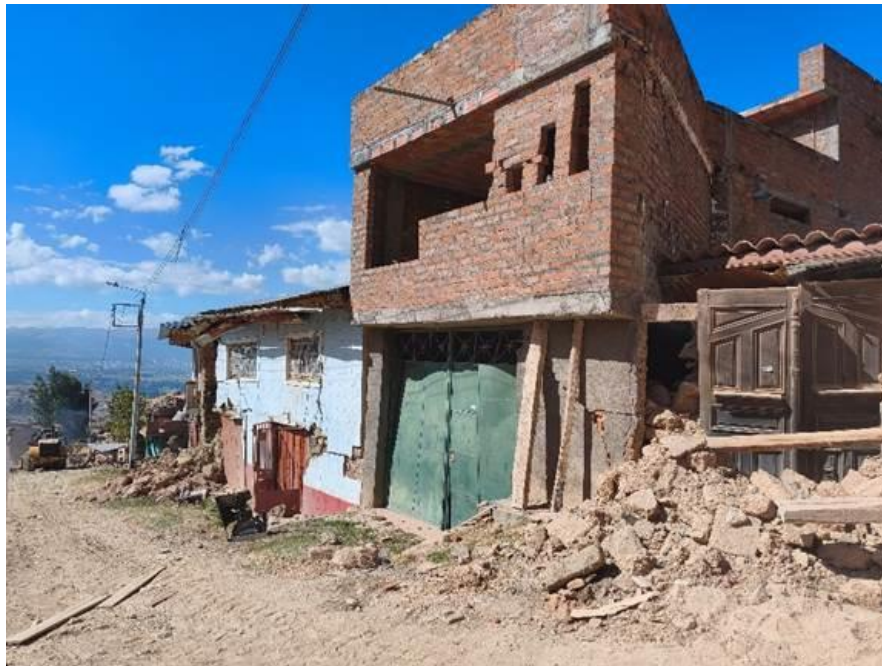
Figura 31 Daño en estructura de albañilería con ladrillos de arcilla cocida sin confinamiento.
