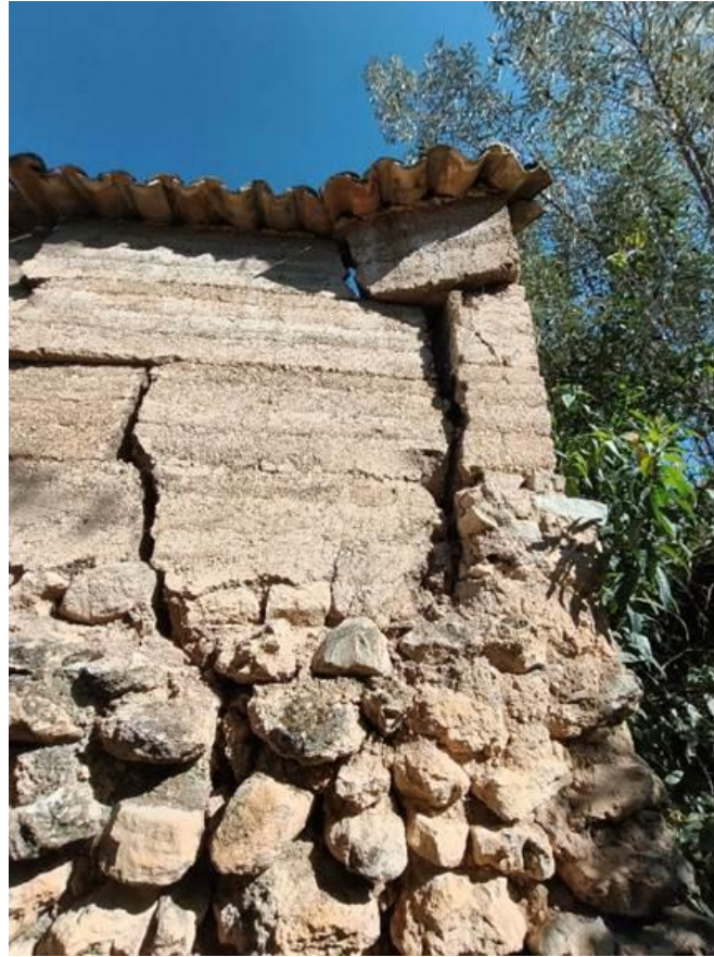
Figura 33 Daño en estructura de tapial con sobrecimiento de piedra.
